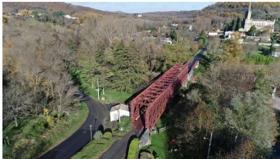
Photo aérienne du chantier de construction de la voie verte entre Sainte-Colombe-sur-l'Hers et Chalabre. © Heli 11 - Département de l'Aude
